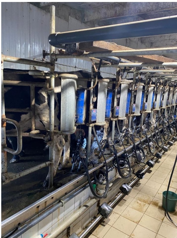
Рисунок 6 – Доильный зал с доильной установкой типа «Ёлочка» от компании «DeLaval»
